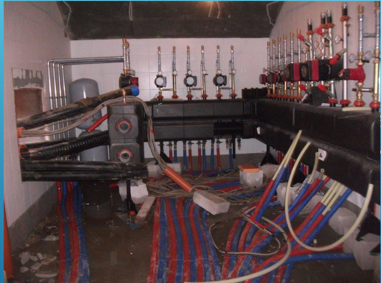
Ввод труб: вода, тепло, канализация, чиллеры
